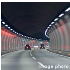
■ トンネル内LED照明
